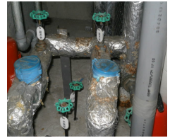
(パイプシャフト内) 給水バルブを閉めて、水抜きバルブを開いて下さい
